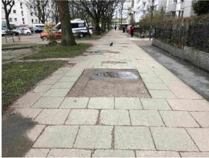
Schadstellen, Randbereich Asphalt
