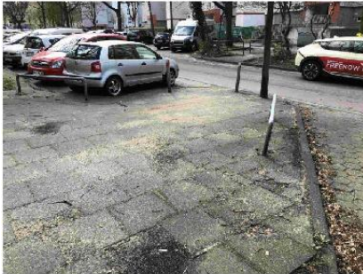
Geländer, Pfosten, Querungsstelle schräg
