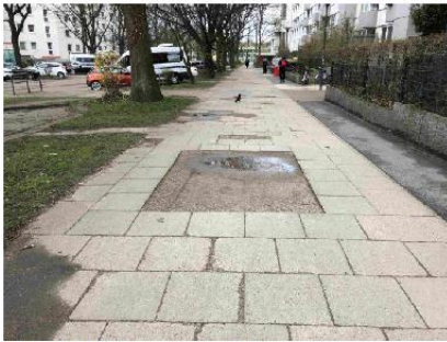
Schadstellen, Randbereich Asphalt
